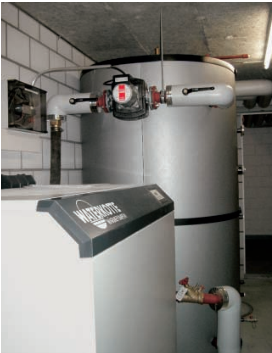
Jeder dritte Bauherr entscheidet sich heute für eine Wärmepumpenheizung, wie die Auswertung von 392 Baubewilligungen für Mehrfamilienhäuser aufzeigte. (Foto EuroTherm)
